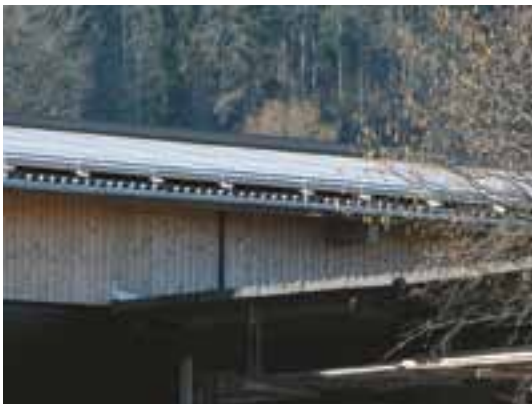
Das «Energie»-Dach von Landwirt Beat Gätzi in Maur.
