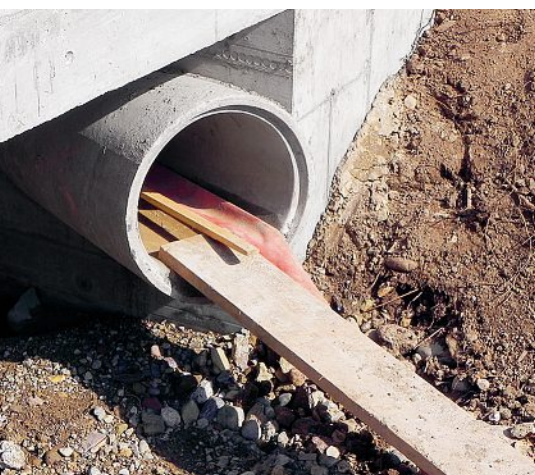
Die alte Röhre mit 60 cm Durchmesser genügte den Anforderungen nicht mehr.
